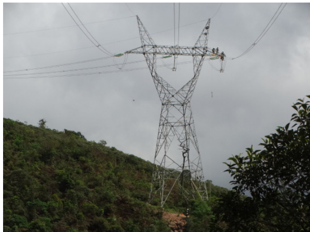
Trecho da LT 345 kV do Complexo Germano
