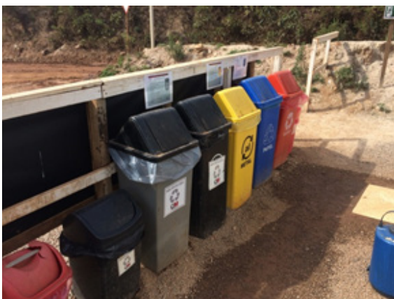
Contenedores de resíduos para coleta seletiva em frente de obra próximo ao Dique S3 Fonte: Samarco, 2016.
