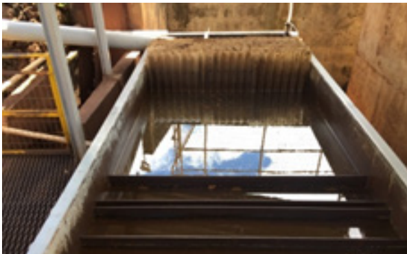
Separador de Água e Óleo Fonte: Samarco, 2016
