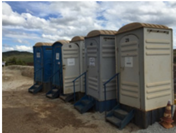
Banheiros químicos instalados em frente de trabalho próxima às obras do Dique S3 Fonte: Samarco, 2016.
