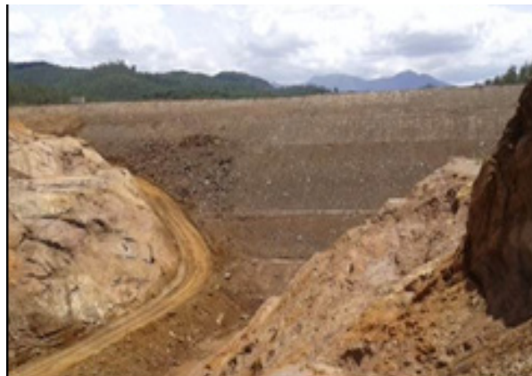
Vista frontal do talude de jusante da Barragem de Santarém após implantação do reforço.
