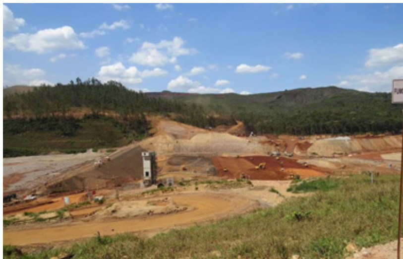
Obras da Nova Barragem de Santarém recuperada à esquerda. Vertedouro Tulipa em concreto (out de 2016). Fonte: BVP, 2016
