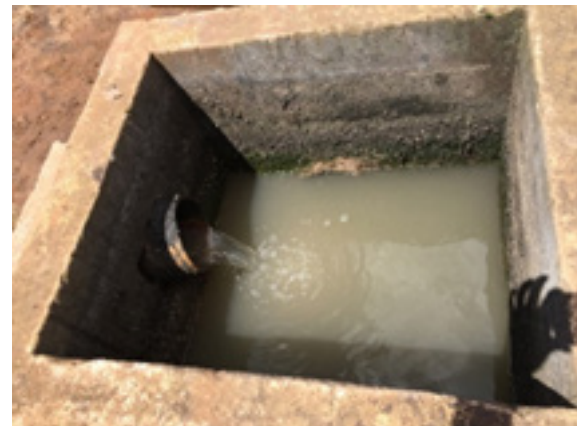
Caixa de entrada da ETE 01 Fonte: Samarco, 2016.
