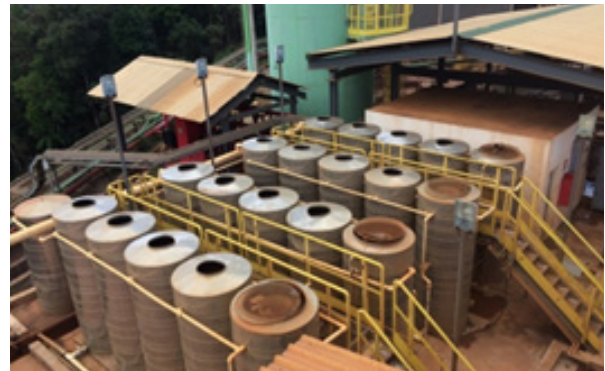
Vista geral da ETEO Fonte: Samarco, 2016
