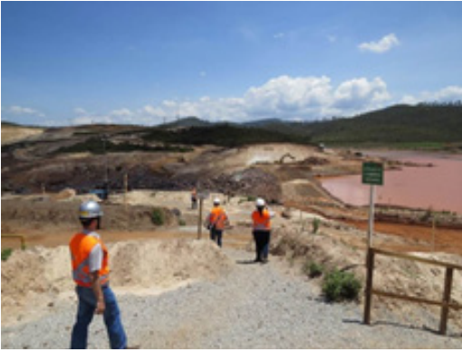
Obras de alteamento do dique S3; notar reservatório assoreado por rejeitos; ao fundo o canal escavado na ombreira direita e, à direita da foto, a foz do córrego Mirandinha
