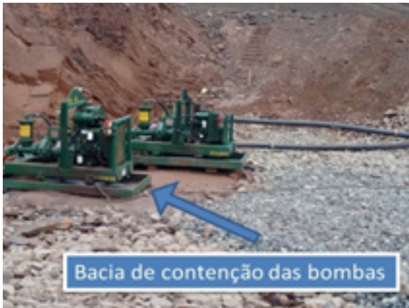
Bombas munidas com bacias de contenção de efluente Fonte: Samarco, 2016.
