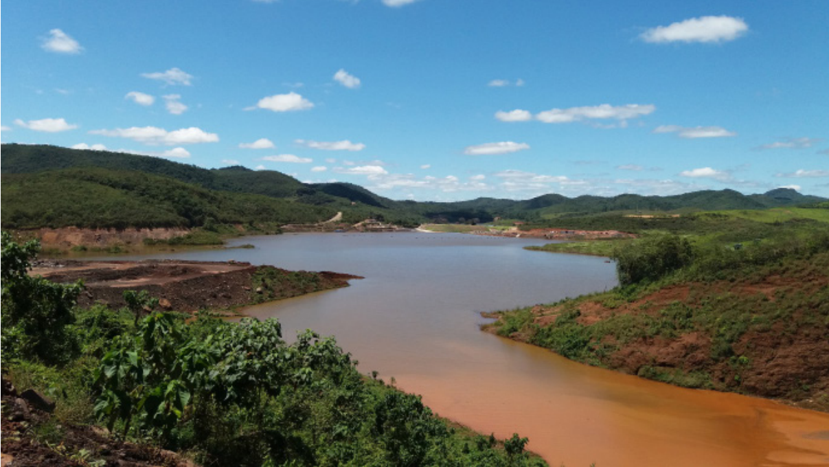
Área de implantação da obra emergencial do Dique S3, para conter sedimentos antes da chegada aos cursos d'água.
