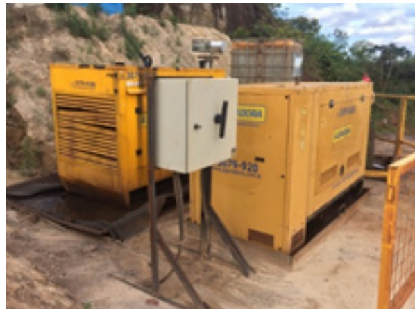
Bacias de contenção sob geradores Fonte: Samarco, 2016.
