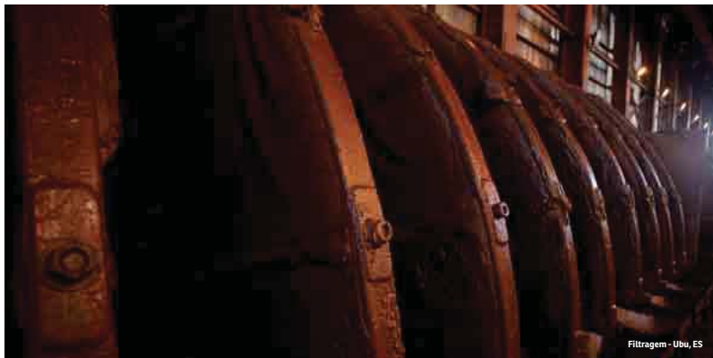
Filtragem - Ubu, ES
