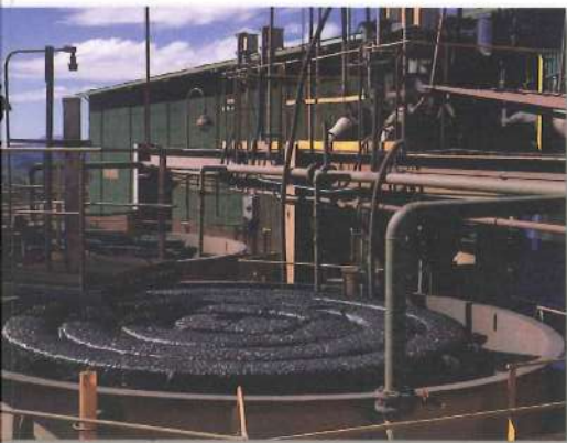
Correia transportadora de minério instaladas na mina de Alegria e, abaixo, colunas de flotação
